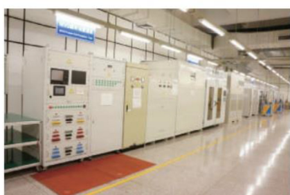
Зона проверки функционирования силовых ячеек
